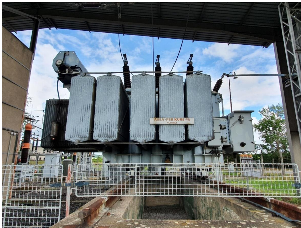
Obrázek 4 Výkonové transformátory v TNS Vraňany
