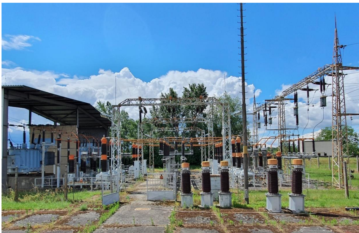
Obrázek 2 Rozvodna Vraňany 110 kV
