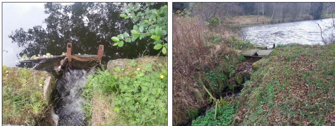
Obrázek č. 13, 14 – vlevo torzo požeráku rybníku u hotelu Ostrov, původně železobetonový s dřevěnými hradítky; pravý obrázek odtok z rybníku u hotelu Ostrov s polorozpadlou lávkou přes koryto odtoku (zdroj: vlastní)
