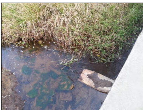
Obrázek č. 10 – deformované přítokové potrubí koupaliště (zdroj: vlastní)
