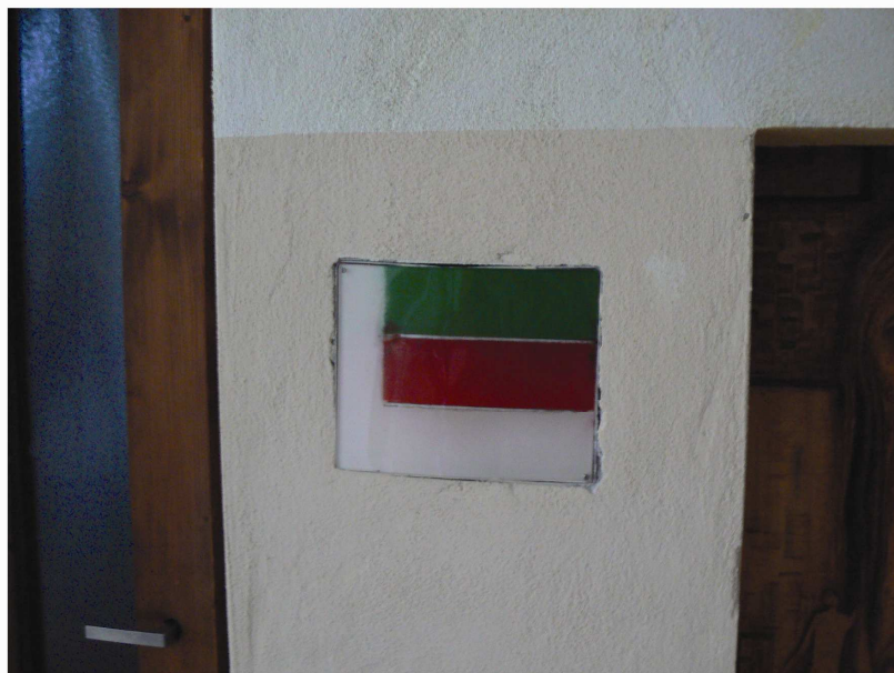
obr. č. 27 signalizace u zповědní místnosti
