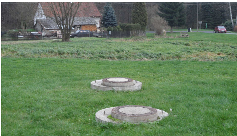
Foto č. 16: Kořenová čistírna v obci Srbská kamenice (foto 2013).
