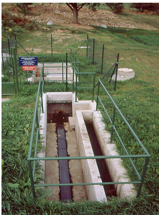
Foto č. 14: Lapák písku, česle a štěrbinová nádrž na KČOV Petrovice u Havlíčkova Brodu (Vymazal 2004).
