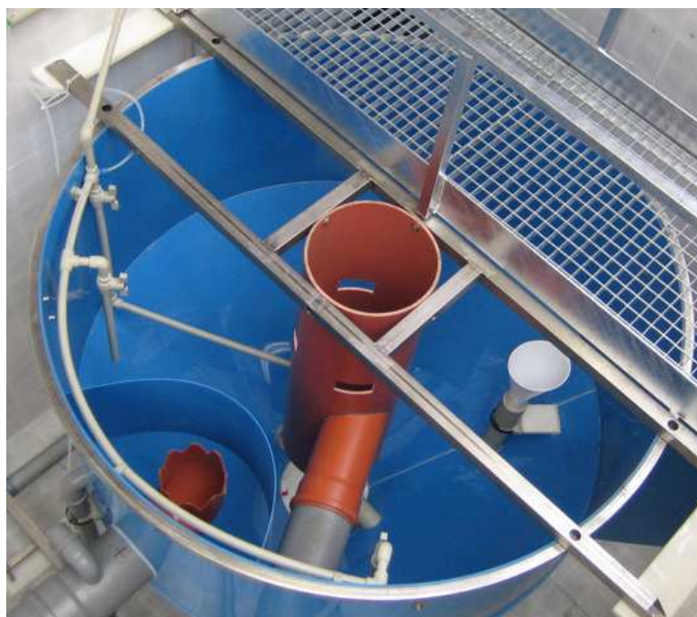
Foto č. 12: Dosazovací zóna – čistírna „BioCleaner BC 150“ od firmy ENVI-PUR s. r. o. ( www.envi-pur.cz ) (cit. 2014. 02. 20).
