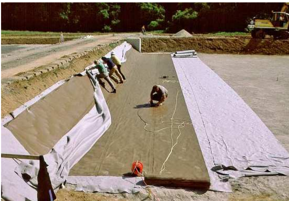
Příloha č. 6.: Plastovou folii je nutno podložit a překrýt geotextílií - KČOV Mořina (Vymazal 2004).
