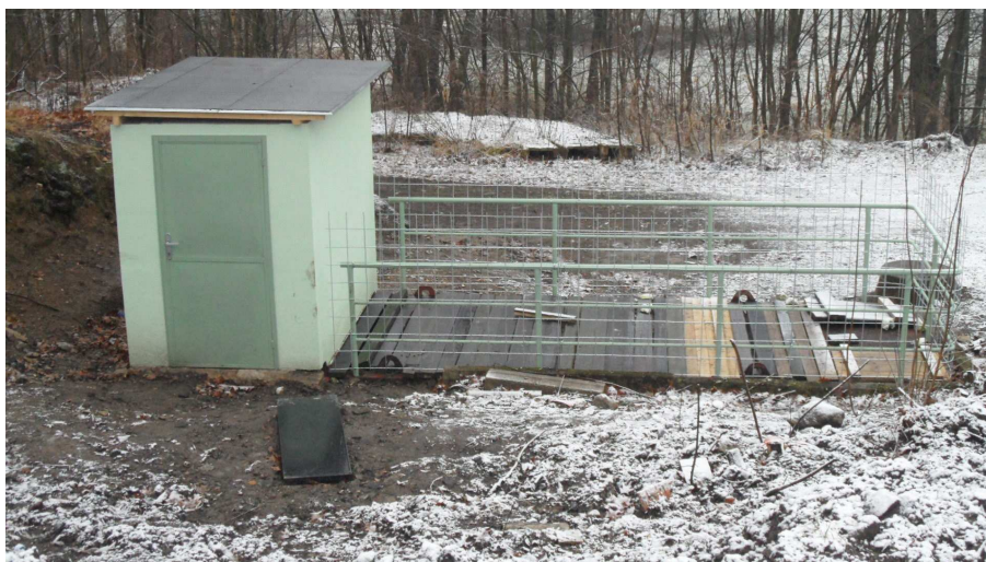
Foto č. 17: Mechanicko - biologická čistírna v obci Markvartice (pro 150 EO) (foto 2013).
