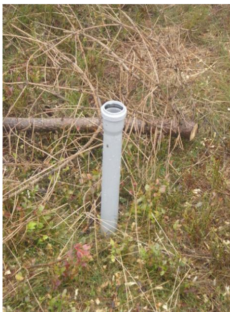
(Obr. č. 16., vystrojená pozorovací sonda podzemní vody, autor: Kamila Krosová)
