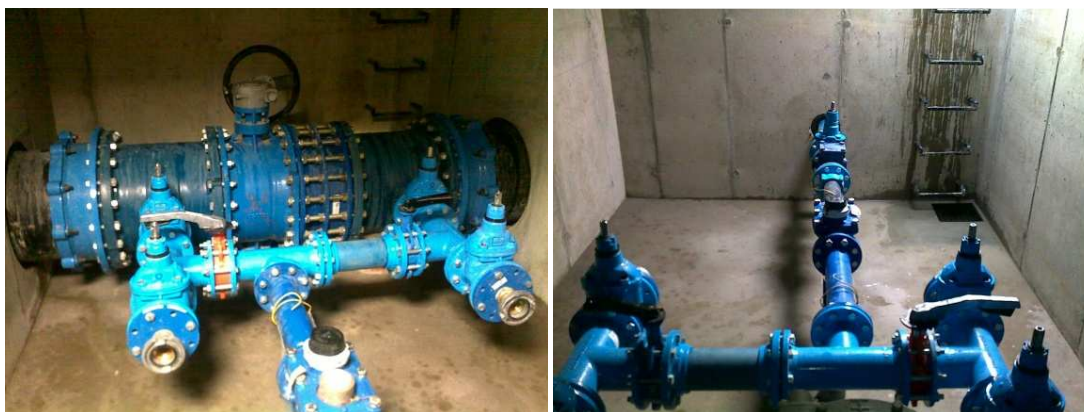
Obr. 24 - vystrojení vodoměrné armaturní šachty
