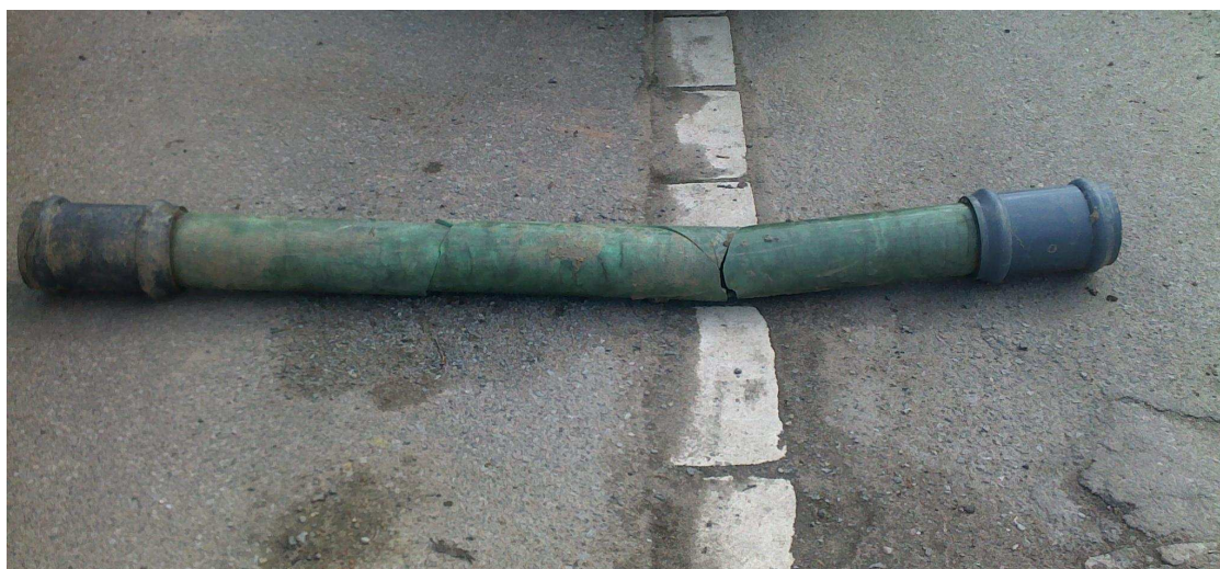
Obr. 2 - podélná a příčná trhлина na PVC DN 150
