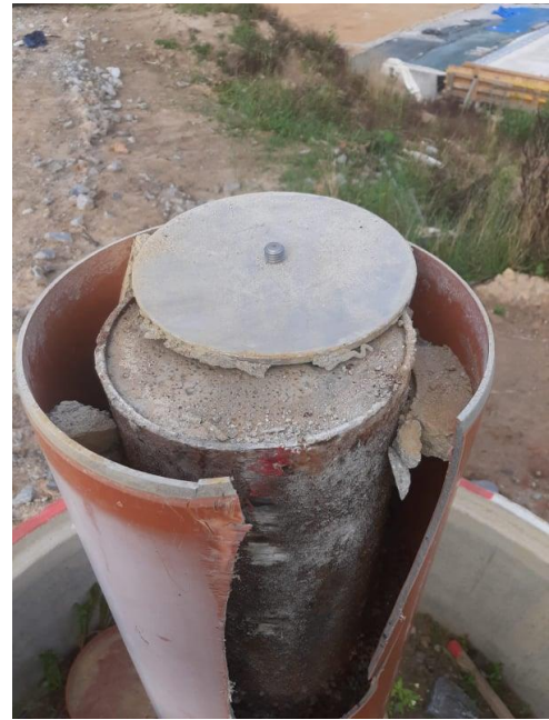
Obrázek 2.4: Fotografie poškozené LMS (vlastní)
