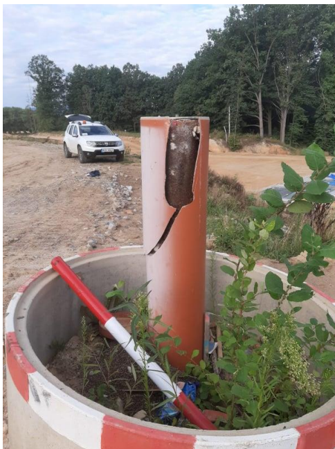
Obrázek 2.5: Fotografie poškozené LMS (vlastní)
