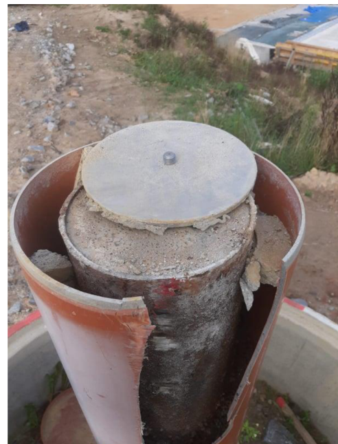
Obrázek 2.4: Fotografie poškozené LMS (vlastní)
