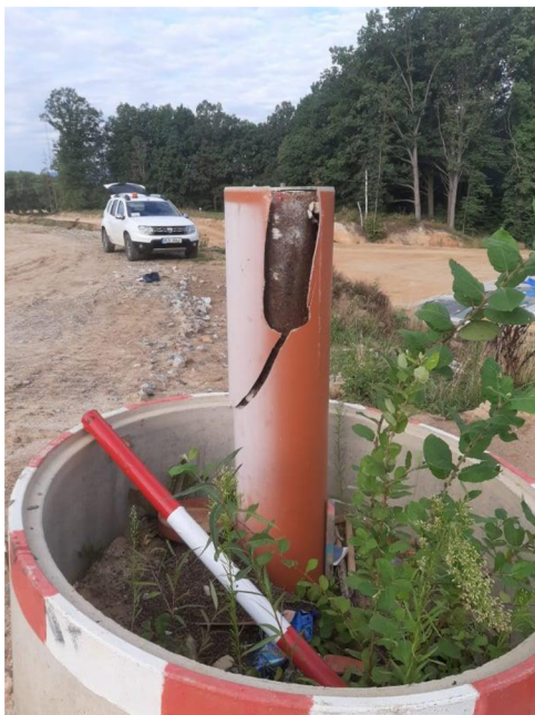
Obrázek 2.5: Fotografie poškozené LMS (vlastní)
