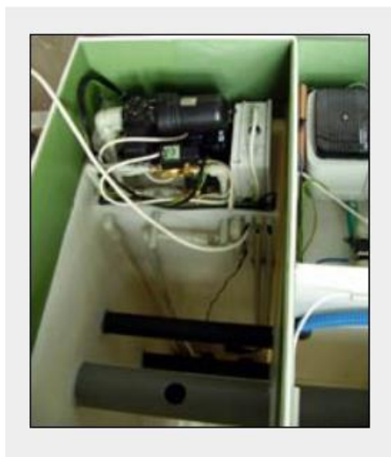
Obrázek 20: Membránová mikrofiltrace po instalaci [21]
