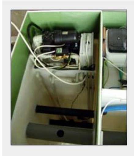
Obrázek 20: Membránová mikrofiltrace po instalaci [21]
