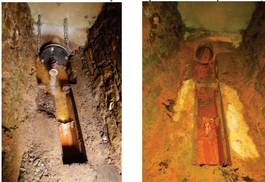
Obr. 28: Uzavírací ventil na výtokovém potrubí v Štole 14 pomocníků (nový, původní).
