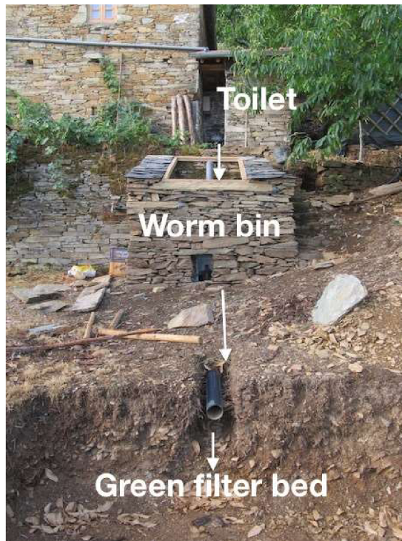
Obrázek č. 7: Výstavba vermifiltrované toalety (toilet – toaleta, worm bin – nádrž s žížalami, green filter bed – zelené filtrační lože) (Zdroj: [70])
