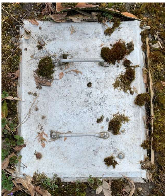
Obrázek č. 23: Poklop od biologického septiku (Zdroj: autor)
