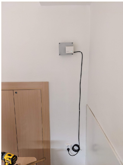
Obrázek 13: Měřící zařízení typu PMB-W na učebně 213 Zdroj: [autor]
