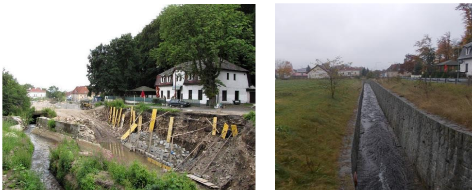
Obr. č. 32, 33 – Na levém obrázku stavební úpravy při budování opevnění budoucího koryta, vlevo na obrázku starý vstup do zakrytí; Na pravém obrázku dokončena revitalizace a současná podoba koryta Bílého potoka (Aulický a Setvák 2010; autor 2014).
