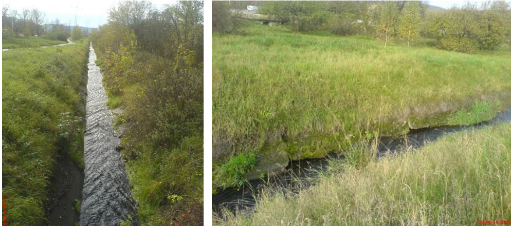
Obr. č. 44, 45 – Napřímení koryta v monolitickém betonovém profilu; Poškození břehů a zarůstání mechorosty a travinami (autor 2014).
