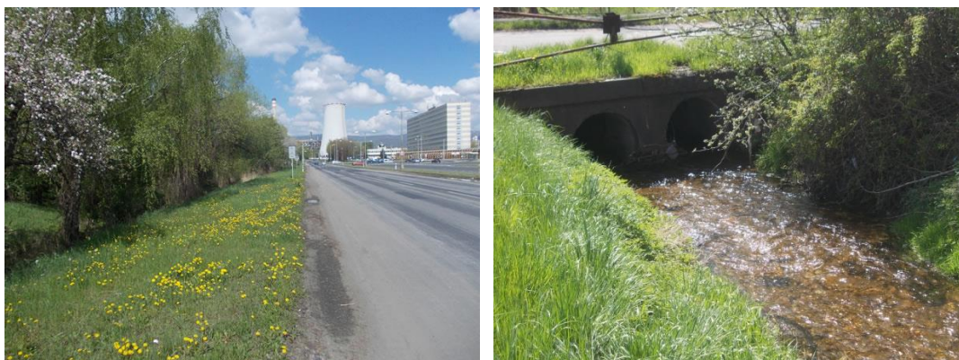
Obr. č. 50, 51 – V tomto úseku protéká potok podél frekventované silnice I/27; Průchod potoka propustkem, před kterým je nahromaděno několik spadlých větví, které mohou ovlivnit průtočnost v daném úseku (autor 2014).
