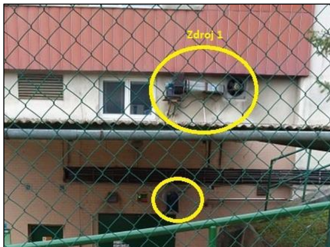
Obrázek 19 – zdroj 1, VZT jednotka
