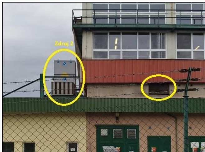
Obrázek 20 – Zdroj 2, kondenzační jednotka + ventilace
