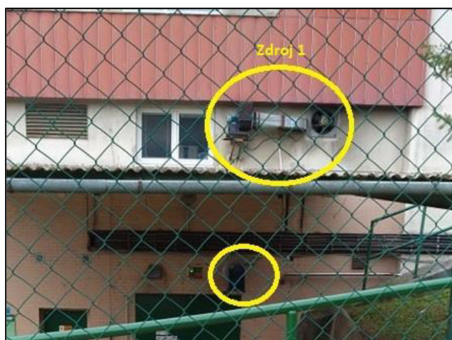
Obrázek 19 – zdroj 1, VZT jednotka
