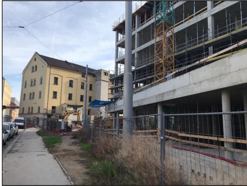
Obrázek 25 – Primární zdroj hluku v okolí budovy, těžké pracovní stroje
