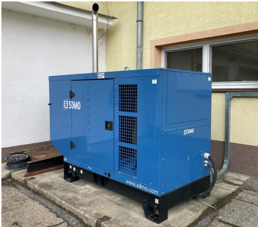
Obrázek 9 dieselangregát pro zásobování ZOS ZZS JČK
