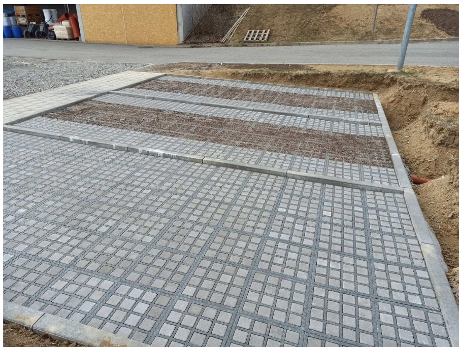
Obr. 4.5 Parkoviště z AS-TTE roštů na pozemcích centra AdMaS (foto po vysetí trávy, v popředí varianta 2, dále varianta 1 ve verzi s a bez biocharu)
