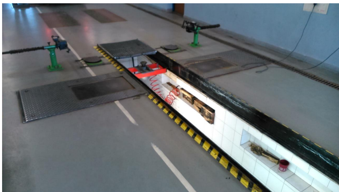
Obrázek 20 Montážní jáma s hydraulickým zvedákem a zařízení ke zjišťování vůli přední nápravy
