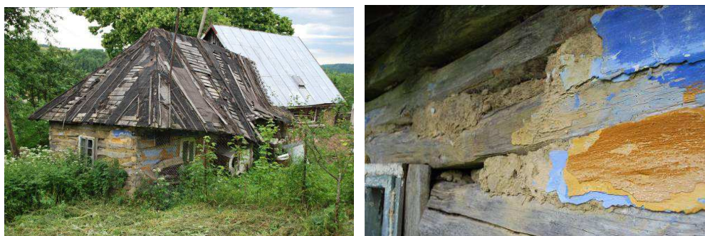
Foto 21 vlevo pohled na rozpadající se usedlost Vápenice č. p. 45, vpravo pohled na hlavní průčelí a detail omítky, r. 2010. A. Korčáková.
