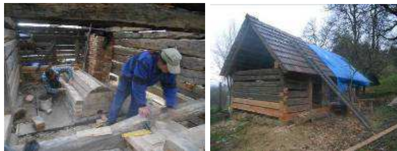
Vlachovice, Doruškova sušárna. Vlevo stavění pece, vpravo probíhající rekonstrukce sušárny, 3. 11. 2013. Foto A. Korčáková.
