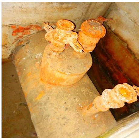
Obr. 4.13. Stávající sběrač vzduchu ve vzdušnickové šachtě Я1 na potrubí DN 1 400 prvního řadu přivaděče
