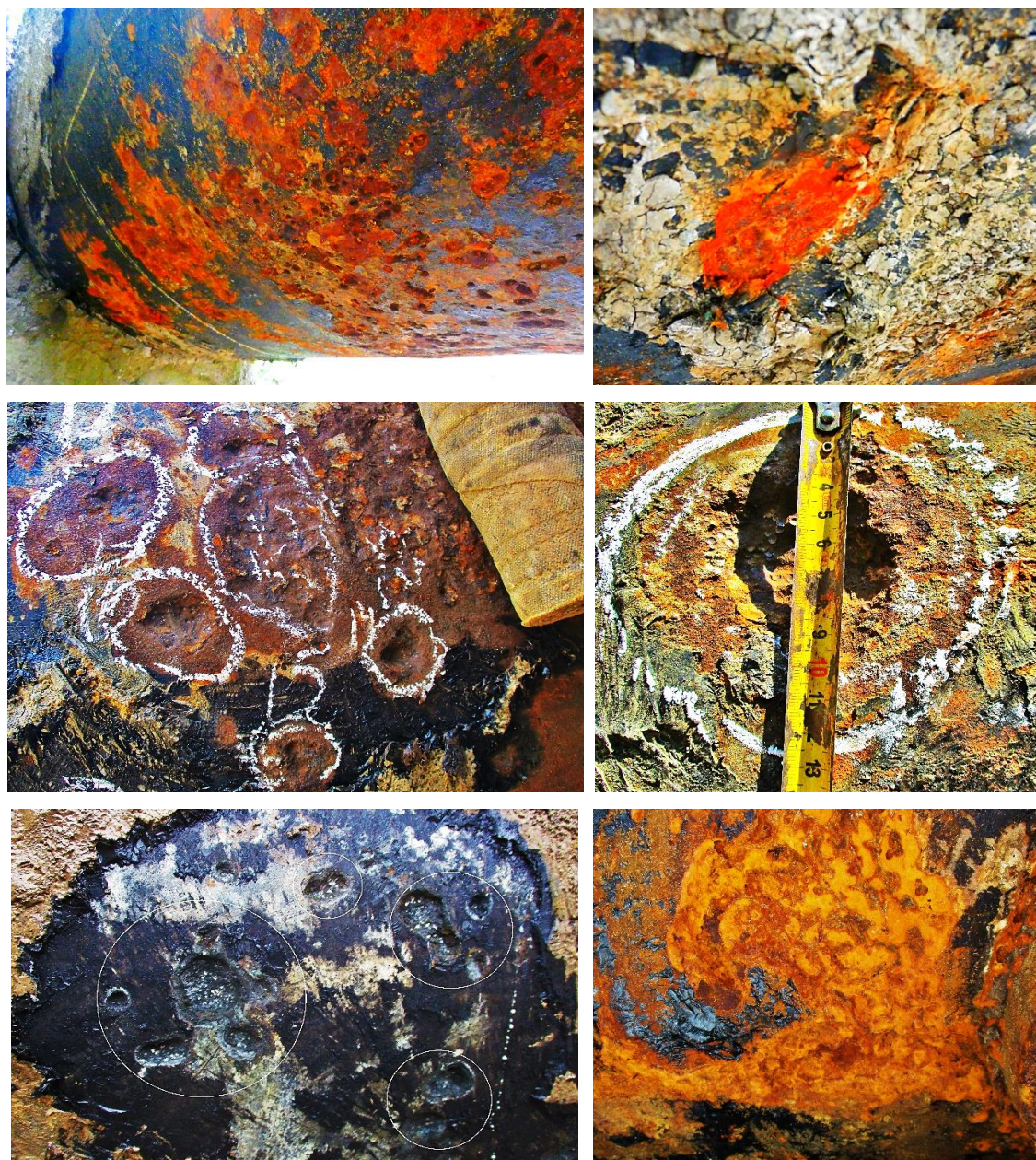
Obr. 3.84, 3.85, 3.86, 3.87, 3.88 a 3.89. Poškození důlkovou korozí se vznikem fistul na úseku délky 300 m prvního řadu přivaděče Dnipro-Mykolajiv u vesnice Myrné
