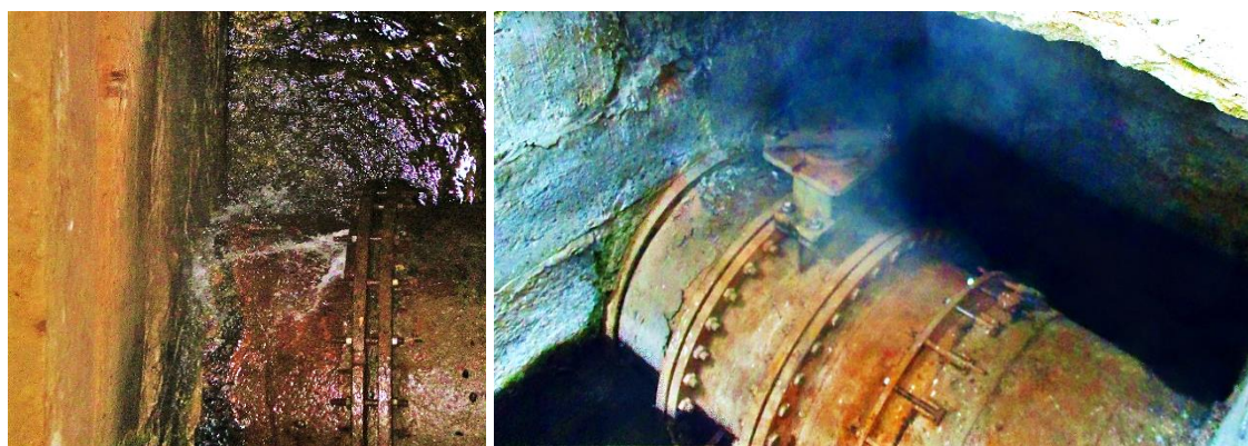
Obr. 3.94, 3.95. Úniky vody z kompenzátorů na prvním a druhém řadu přivaděče [2]
