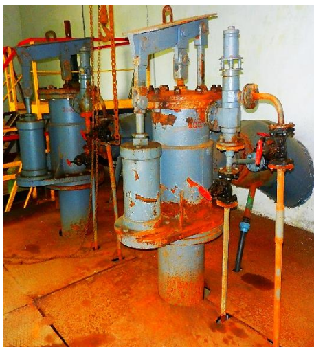
Obr. 3.21. Automatické tlumiče tlakových rázů typu ГY-350 na prvním řadu přivaděče
