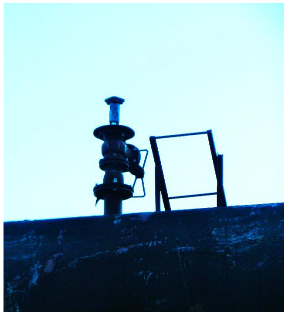
Obr. 3.67. Vzdušník DN 100 č. III' na přemostění prvního řadu přivaděče u úpravny vody Ingulec
