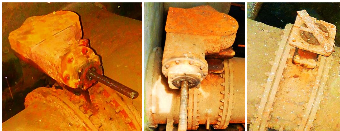
Obr. 3.107, 3.108 a 3.109. Rozebrané čelní převodovky uzavíracích klapek přivaděče
