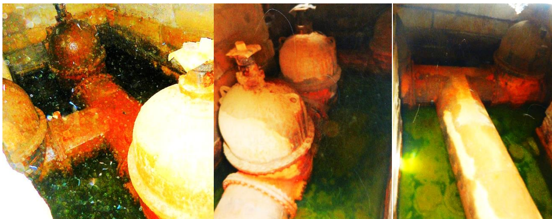
Obr. 3.58, 3.59 a 3.60. Přepínací komora č. 73, 74, 75, 76, 77, 78 s šesti kovovětšnicími litinovými šoupátky DN 1 400 s nestoupajícími vřeteny u dálnice E-58, M-14
