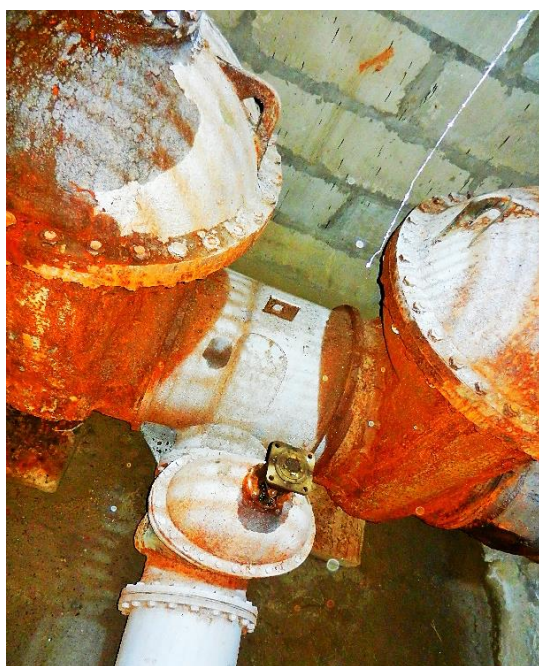
Obr. 3.56. Přepínací komora č. 11, 12 s dvěma kovověšnicími ocelovými šoupátky DN 1 200 se stoupajícími vřeteny a s výpustí č. 4. DN 400 u vesnice Sadové
