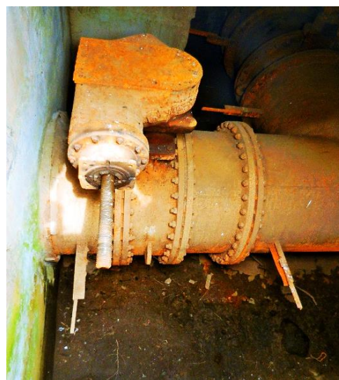
Obr. 3.54. Uzavírací klapka DN 1 200 s ovládání ručním kolem prostřednictvím čelního převodu v armaturní šachtě č. 59, 60, 61 na prvním řadu přivaděče
