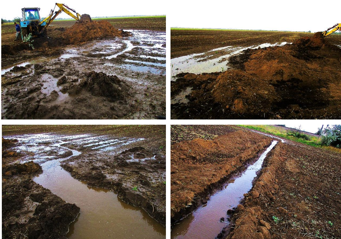
Obr. 3.78, 3.79, 3.80 a 3.81. Likvidace úniku vody na prvním řadu přivaděče Dnipro-Mykolajiv 07. 9. 2018 na úseku mezi vesnicí Myrné a dálnicí E-58, M-14 [2]
