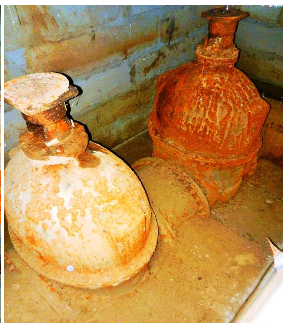
Obr. 3.57. Přepínací komora č. 17, 18 s dvěma kovověšnicími litinovými šoupátky DN 1 200 s nestoupajícími vřeteny
