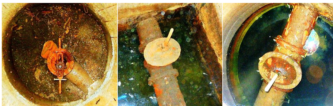
Obr. 3.63. Výpust DN 250 č. 20 na prvním řadu přivaděče u řeky Věrevčyná
