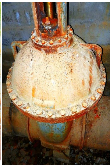
Obr. 3.51. Sekční kovovětšníci ocelové šoupátko DN 1 200 se stoupajícím vřetenem v armaturní šachtě č. 48 na druhém řadu přivaděče
