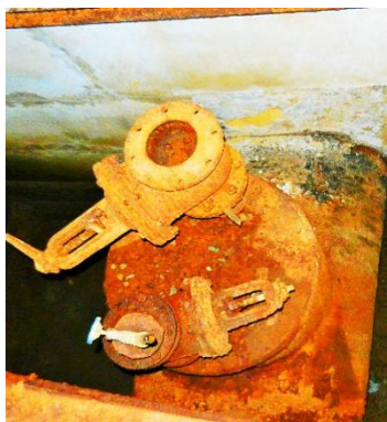
Obr. 3.96. Absence vzdušníku ve vzdušnikové šachtě č. Ж2 na prvním řadu přivaděče
