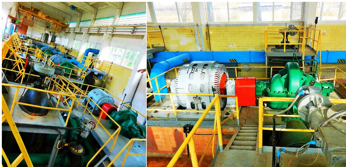
Obr. 3.11 a 3.12. Čerpací stanice prvního zvednutí a čerpadlo Д-6300-80-2 číslo 2
