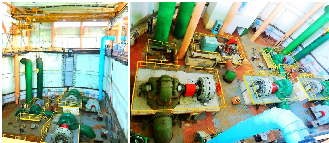
Obr. 3.7 a 3.8. Čerpací stanice nulového zvednutí s čerpadly Д-12500-24 a Д-6300-27
