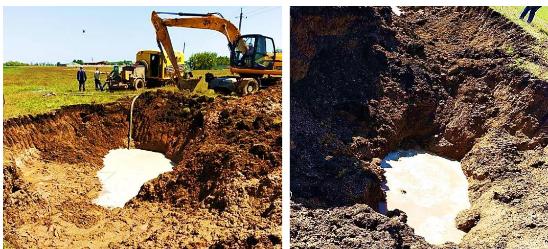
Obr. 3.72, 3.73, 3.74 a 3.75. Likvidace úniku vody 03. 5. 2018 na prvním řadu přivaděče Dnipro-Mykolajiv u vesnice Myrné [2]
