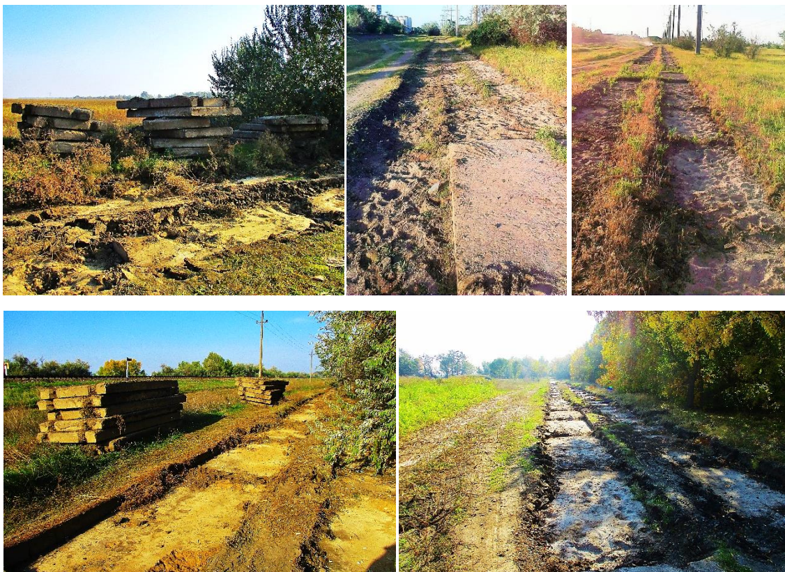
Obr. 3.129, 3.130, 3.131, 3.132 a 3.133. Aktuální stav inspekční komunikace podél přivaděče Dnipro-Mykolajiv
