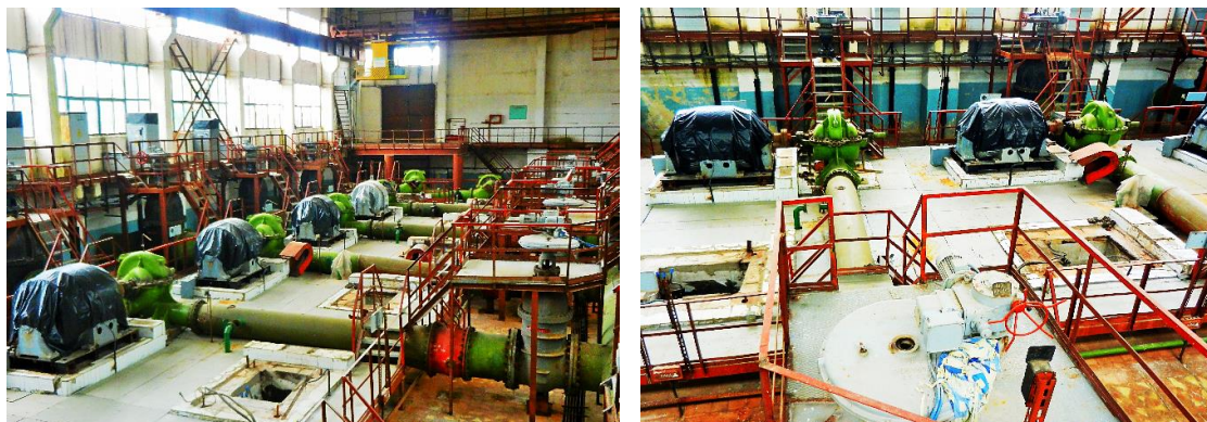
Obr. 3.17 a 3.18. Zvyšovací stanice Cherson a čerpadla Д-3200-75
