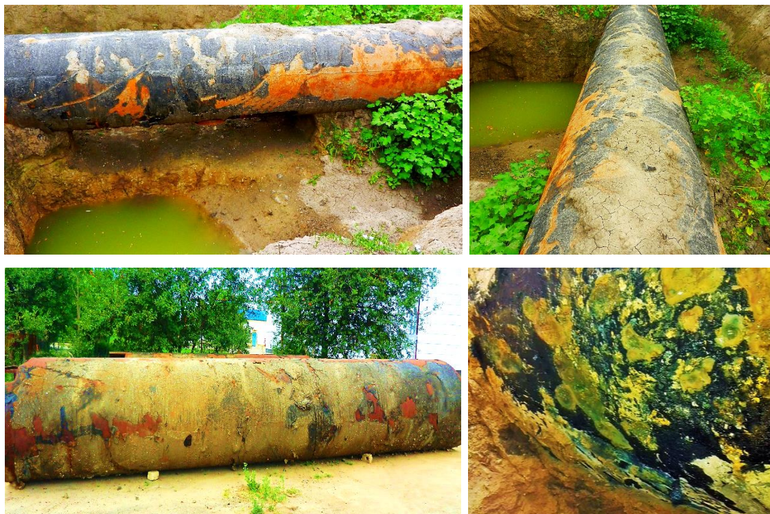
Obr. 3.90, 3.91, 3.92 a 3.93. Stav bitumenové izolace potrubí prvního řadu přivaděče Dnipro-Mykolajiv na úseku v okolí vesnice Myrné
