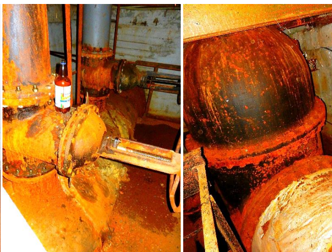
Obr. 3.22 a 3.23. Vystrojení komory tlumičů tlakových rázů č. 1
