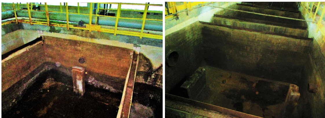
Obr. 3.9 a 3.10. Hala demontovaných mikrosítových filtrů
