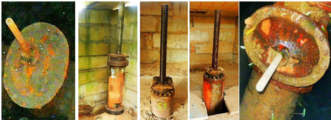
Obr. 3.102, 3.103, 3.104, 3.105, 3.106. Rozebrané čelní převodovky šoupátek přivaděče
