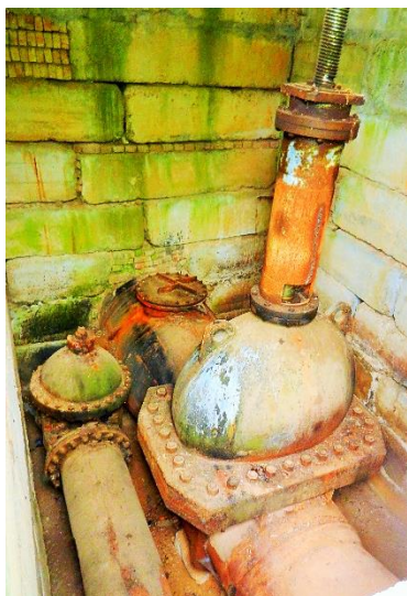
Obr. 3.50. Sekční kovovětšníci ocelové šoupátko DN 1 000 se stoupajícím vřetenem a s bypassovým potrubím opatřeným litinovým šoupátkem DN 500 v armaturní šachtě č. 43 na prvním řadu přivaděče
