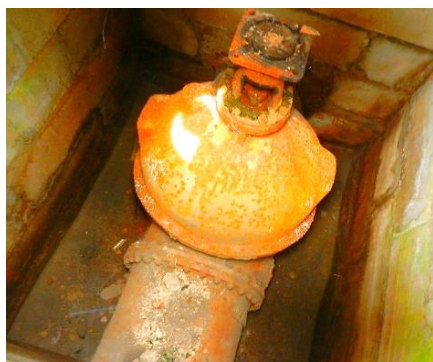
Obr. 4.11. Stávající kovovětšnickí litinové šoupátko 30ч930б DN 1 200 v armaturní šachtě č. 65
