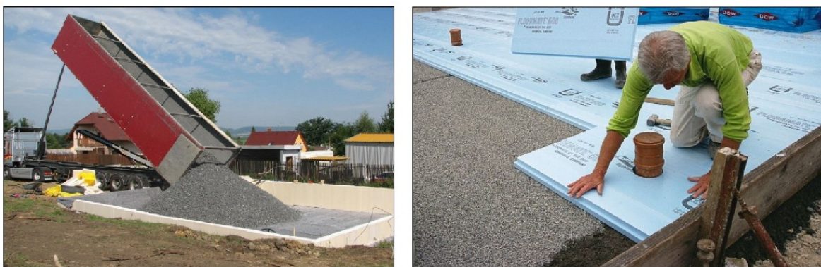
Obr. 5: Založení domu na pěnoskle v bedněné jámě (vlevo) a na deskové izolaci z extrudovaného polystyrenu (vpravo) ( www.tzb-info.cz )
