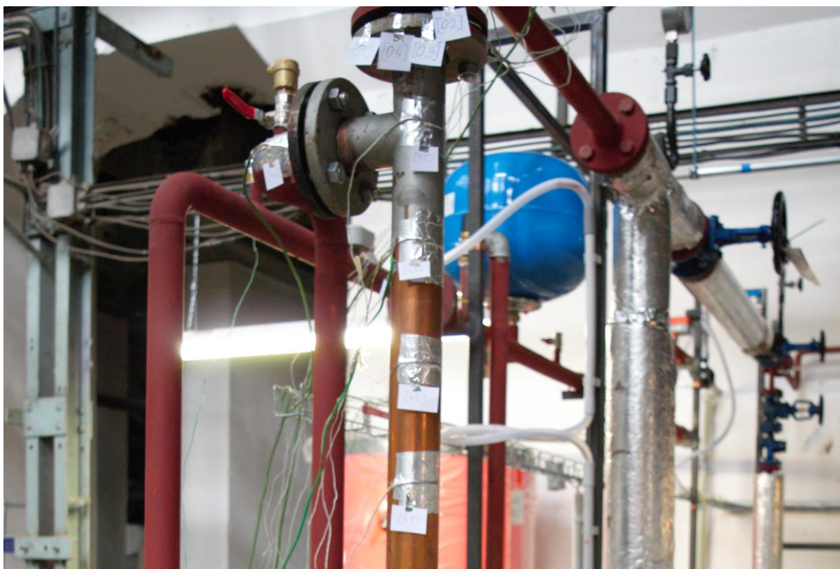
Obr. 20: Měřicí zařízení včetně trubkového výměníku tepla – detail
