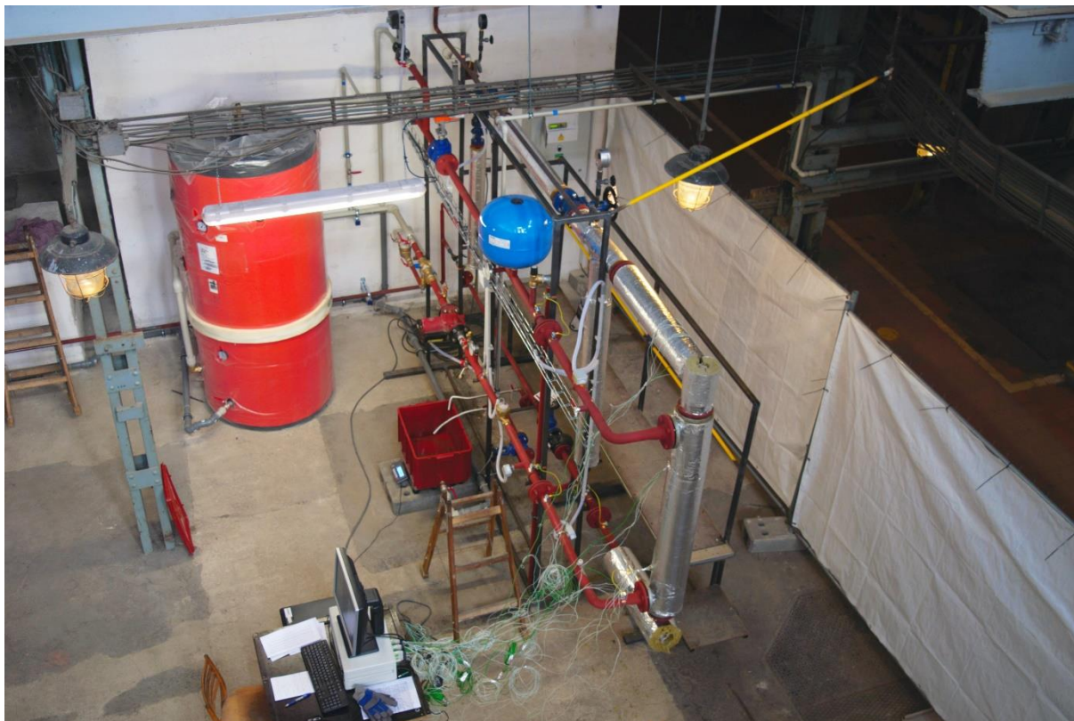
Obr. 19: Měřicí zařízení včetně trubkového výměníku tepla
