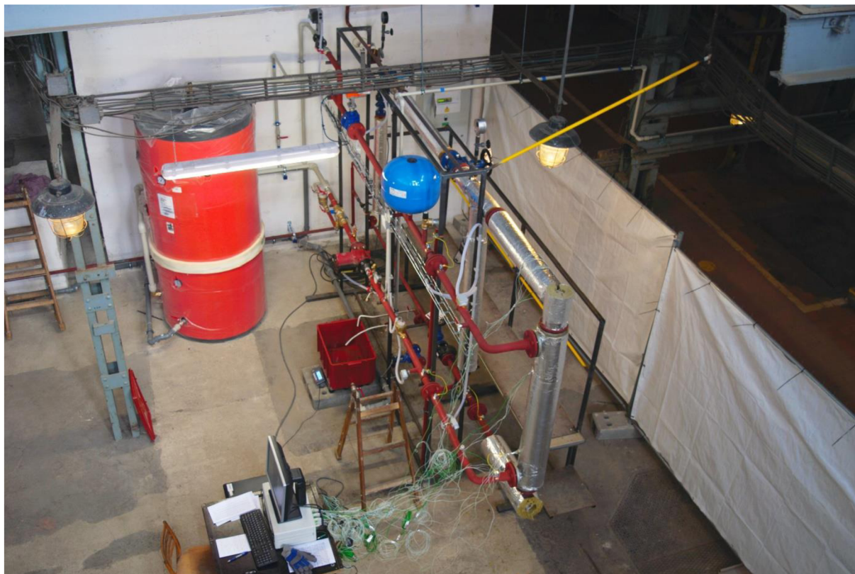
Obr. 19: Měřící zařízení včetně trubkového výměníku tepla
