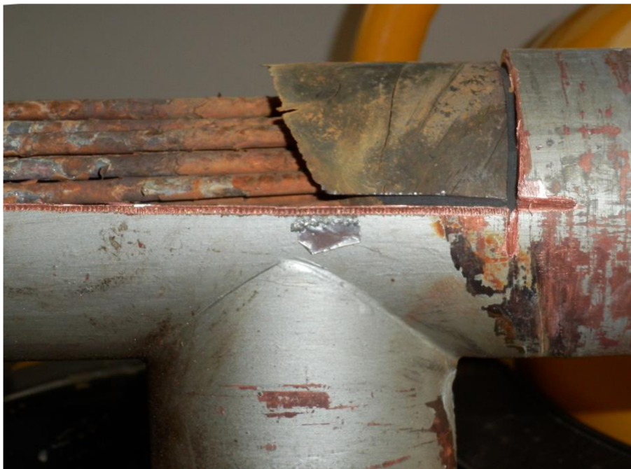
Obr. 16: Detail výměníku – prostor vyplněný tmelem
