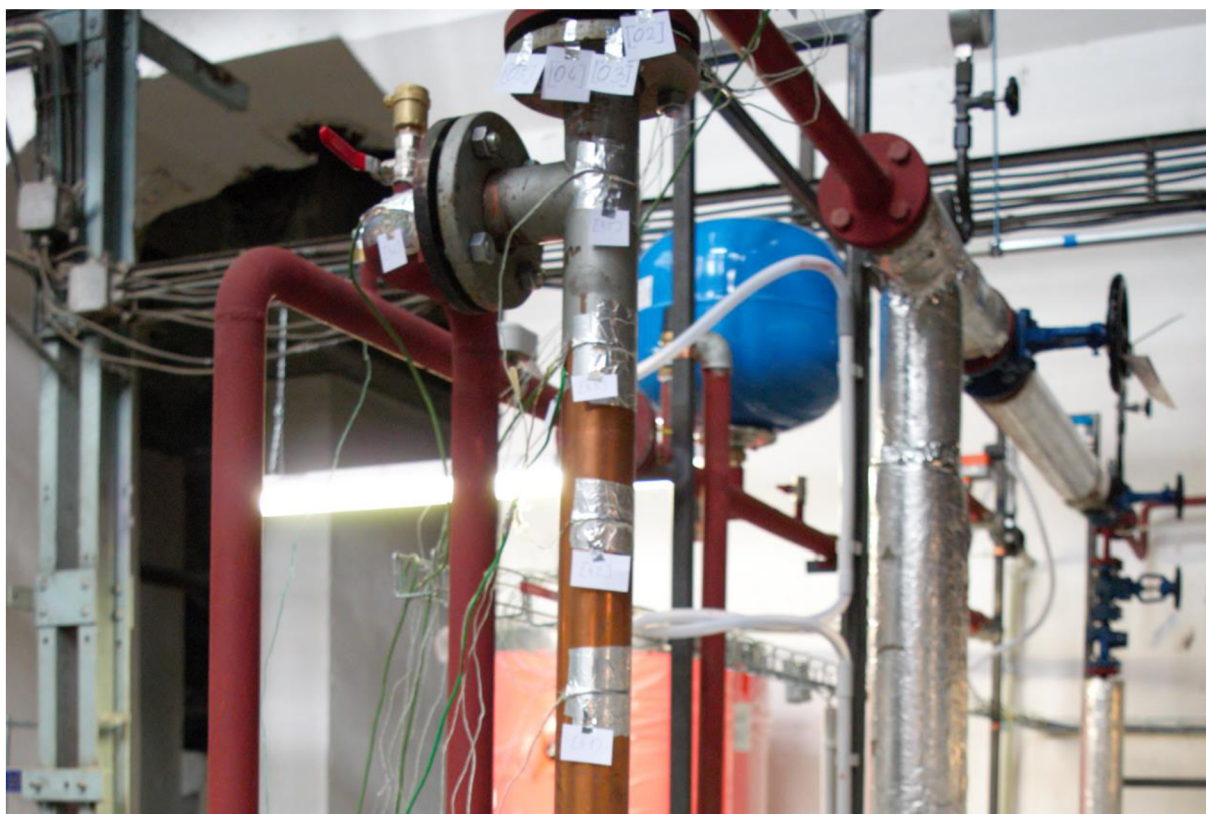
Obr. 20: Měřící zařízení včetně trubkového výměníku tepla – detail
