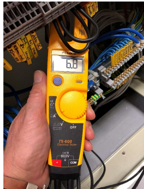
Obr. 9.20: Kontrola napájení DDC
