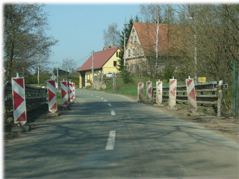
Obrázek č. 9 – Most v havarijním stavu v Otovicích
