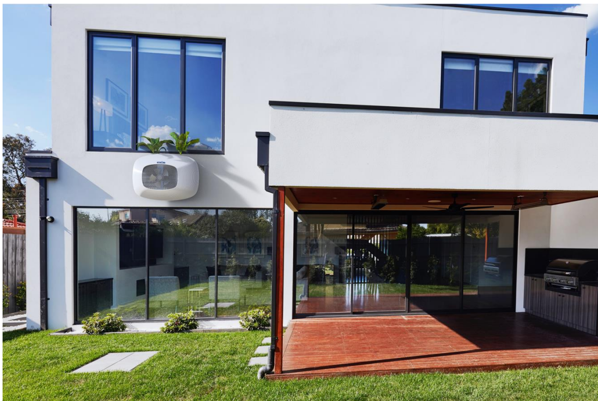
Obr. 5-6 Celkový pohled – venkovní jednotka
