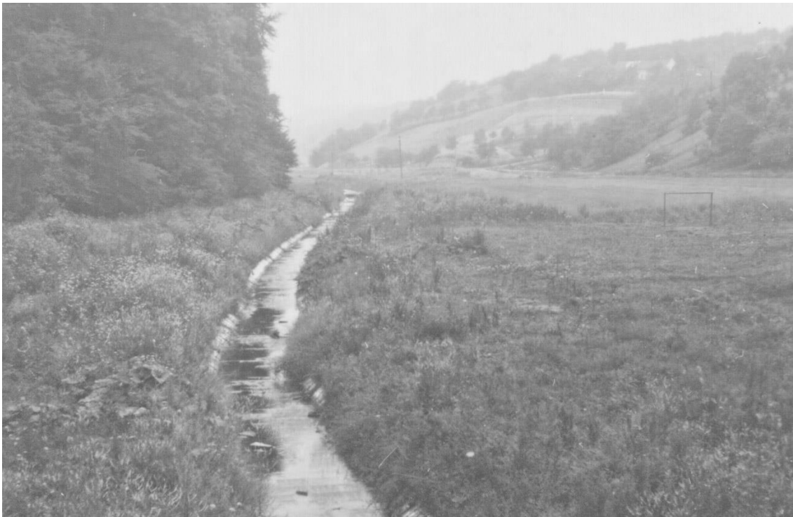
Obr. 3: Historická fotografie nového koryta Širokého potoka pod stráněmi u hřiště vzniklé při stavbě struskovodu z teplárny Kučovaniny z Otrokovic v roce 1969
