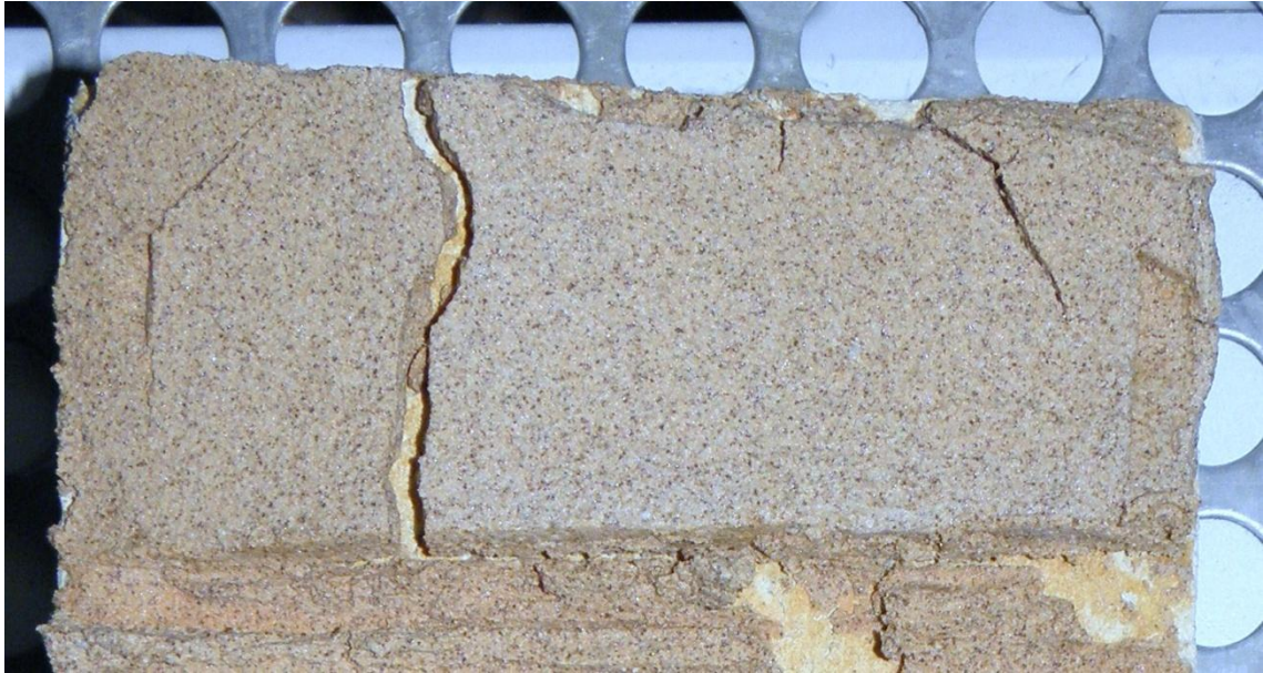
Obr. 9.1: Trhliny vzniklé vlivem smrštění při sušení
