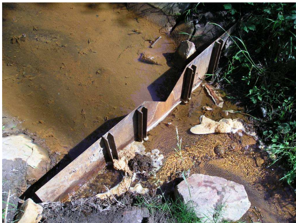
Obrázek 7: Špatně instalovaný Thomsonův měrný přeliv v korytě Červeného potoka pod výstří požeráku (Kebrlová, 2010)
