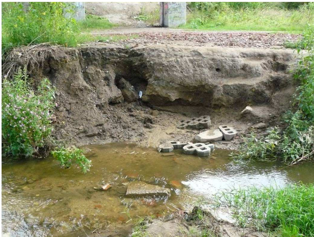
Obrázek 12: Erozí narušený pravý břeh Červeného potoka před vtokem do Velkého Slánského rybníka (Kebrlová 2010)
