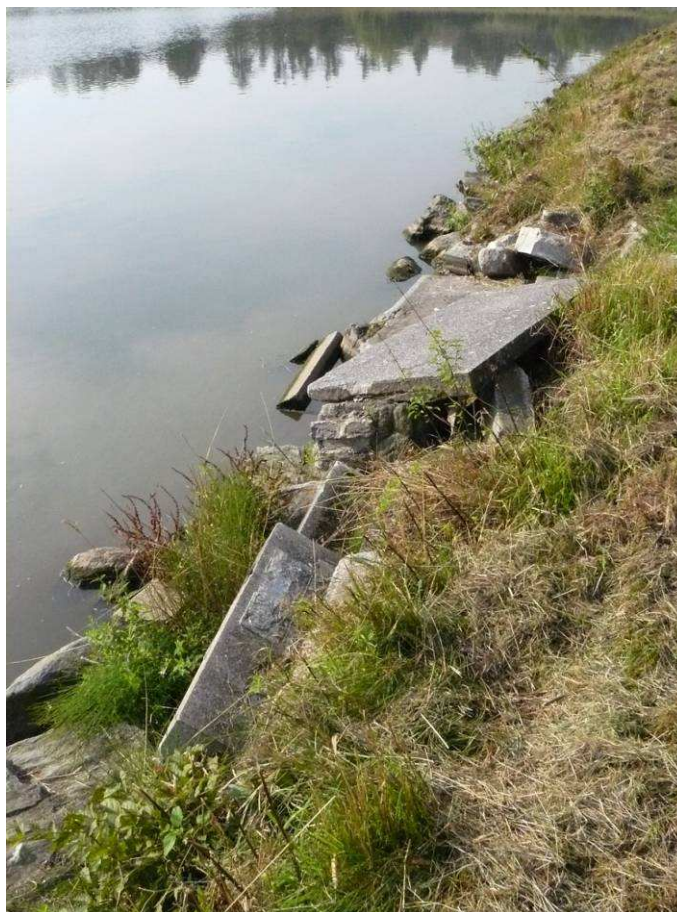
Obrázek 10: Detail opevnění návodního svahu boční hráze - patrné kusy betonu a žulové náhrobní desky (Kebrlová 2010)
