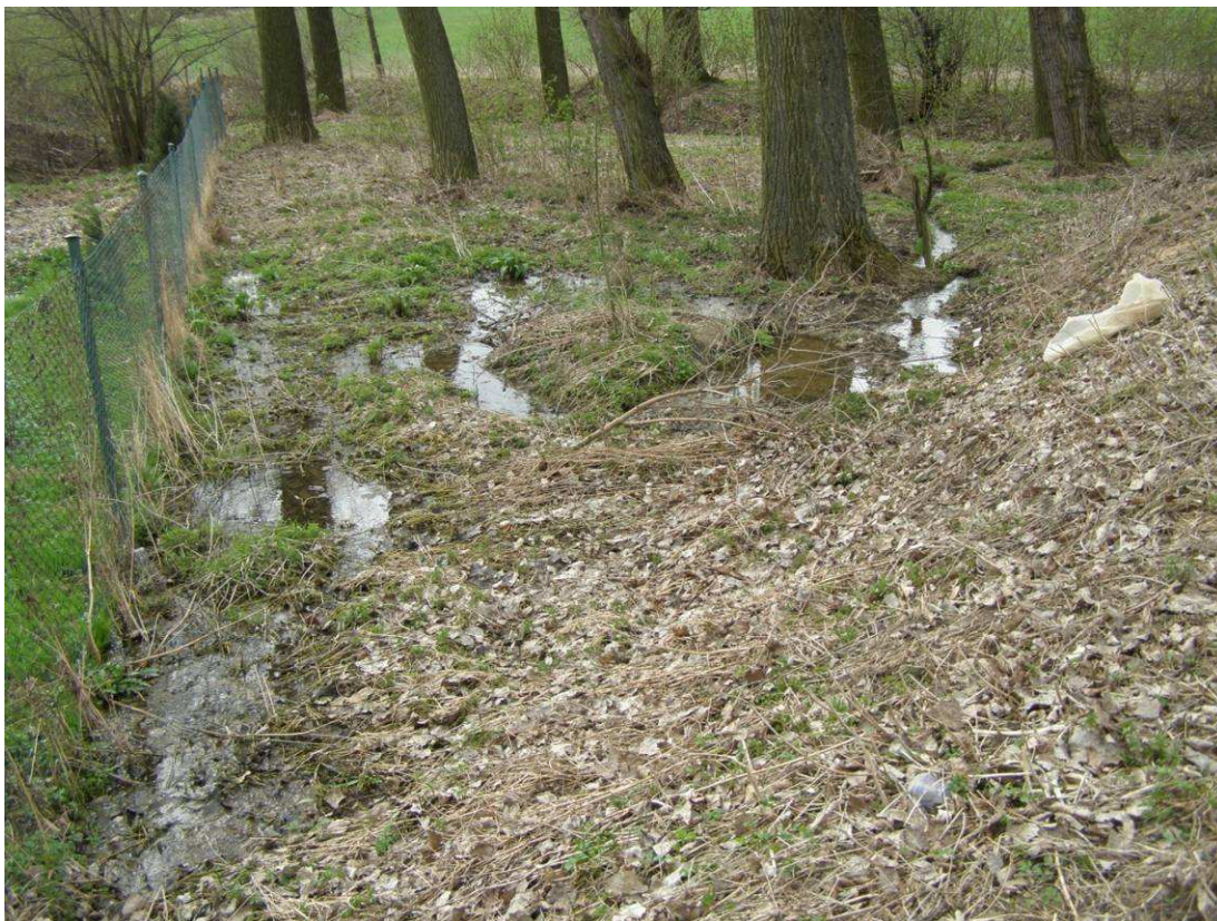
Obrázek 4: Průsak pod čelní hrází hrází (Kebřlová, 2011)
