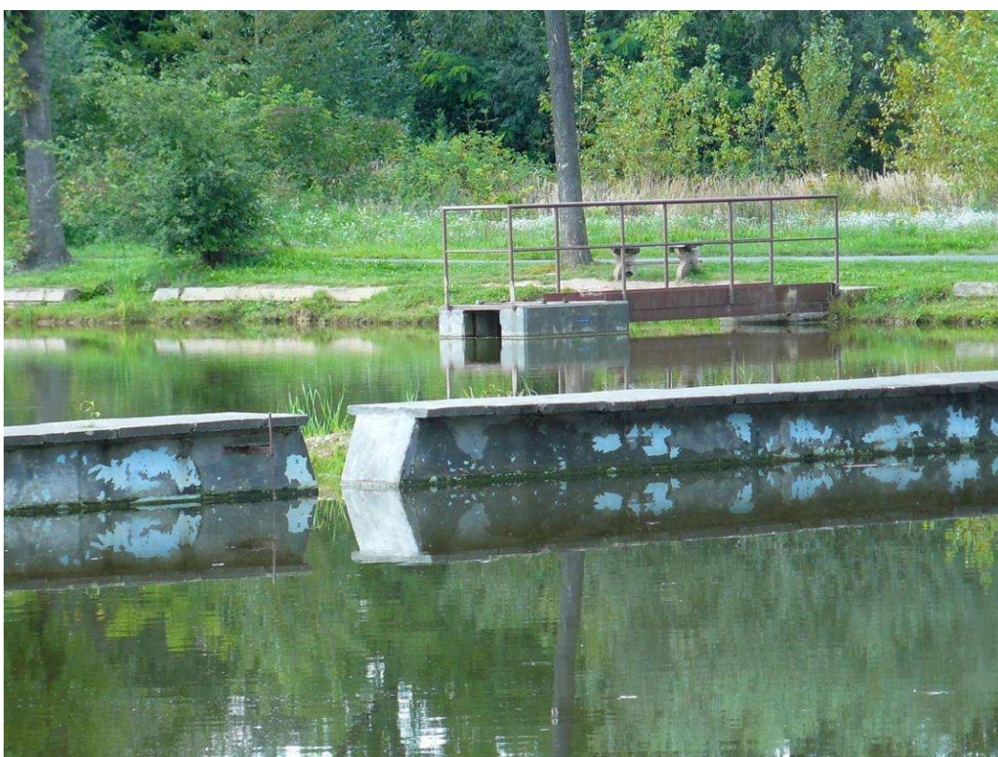
Obrázek 3: Dělicí hráz s otvorem pro přepad vody mezi nádržemi, v pozadí otevřený dvouřadý požerák (Kebrlová, 2010)
