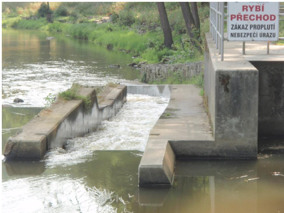
Obrázek 26 : rybí přechod na Horním jezu v Lokti nad Ohří
