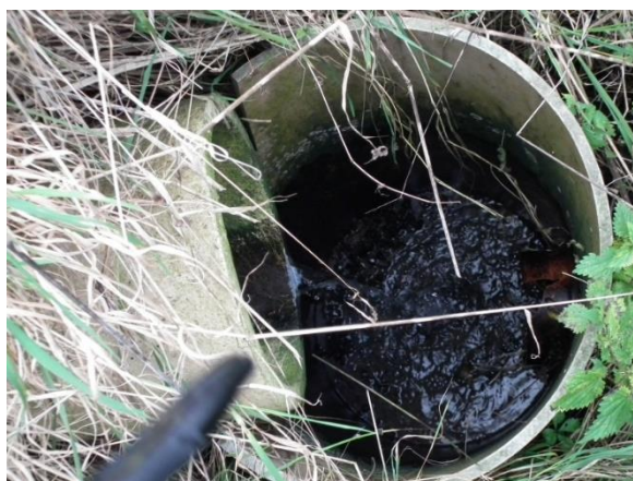
Obr. č. 19: Odpadní vody, které dále vytékají do Stroupinského potoka
