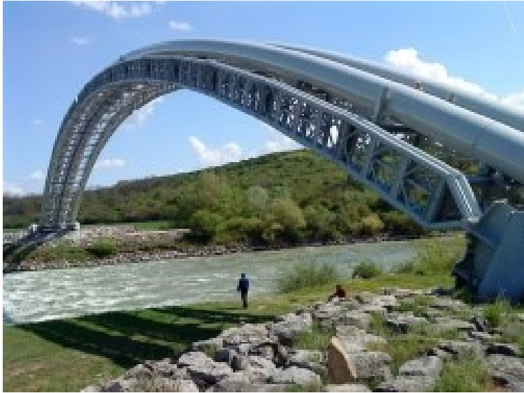
Obr. 1.3 Uložení v nadzemní trase (plynovod)
