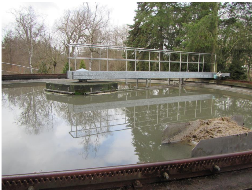
Obr. 9 Usazovací nádrž (autorka)
