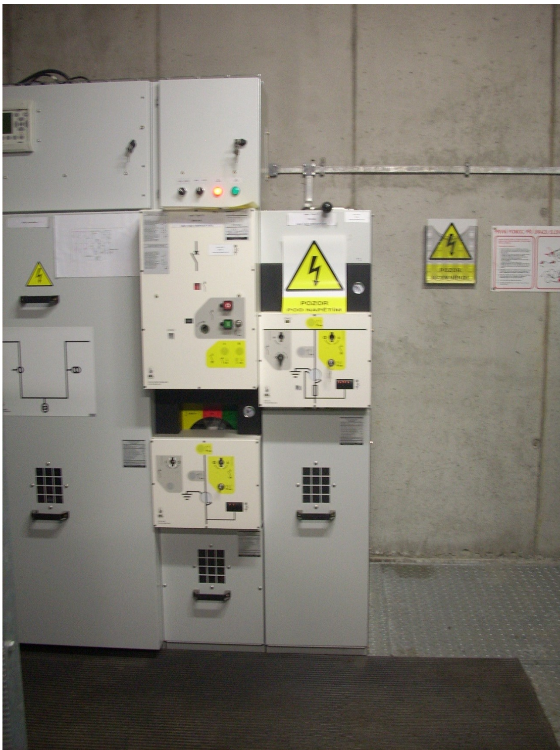
Příloha 11 – Rozvodna MVE Bělov (Veronika Slováková, 15. 3. 2015)
