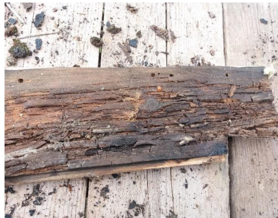
Obrázek 5: Dřevo poškozené hnědou hnilobou
