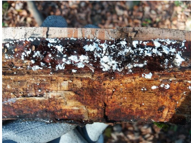
Obrázek 20: Dřevo poškozené plísní
