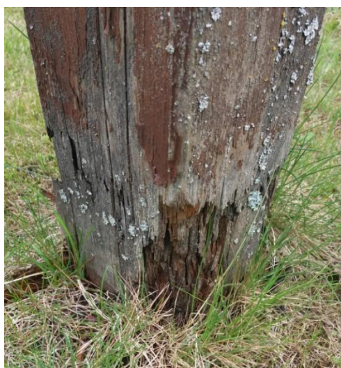
Obrázek 3: Dřevěný sloupek poškozený měkkou hnilobou
