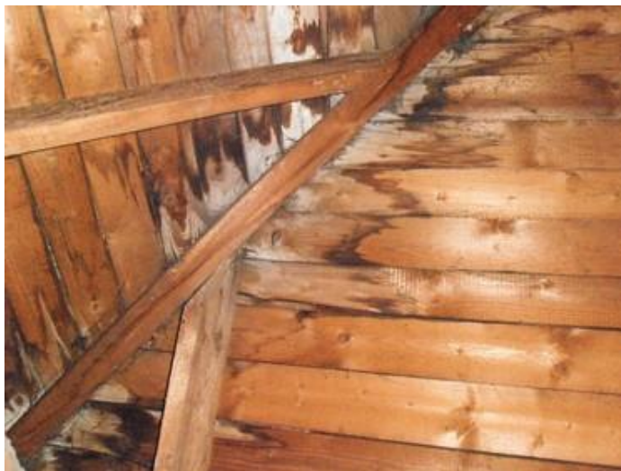
Obrázek 23: Vnikání vody do objektu
