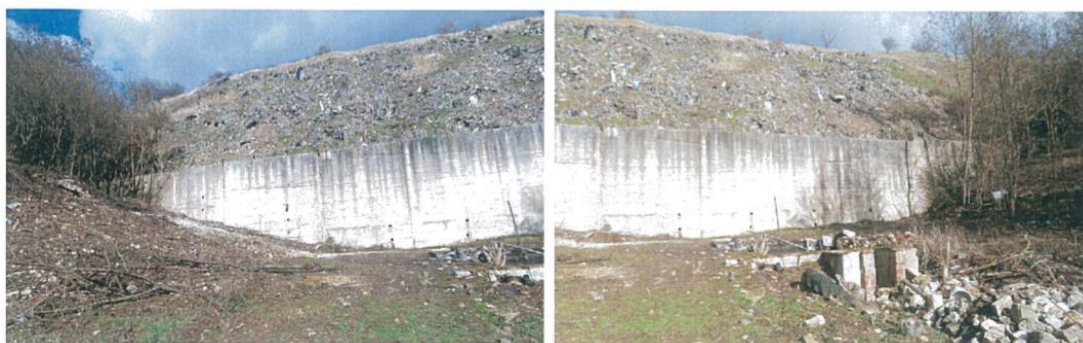
Obrázek 6: Opěrná zed' a nefunkční jímka pod skládkou (CZ BIJO, 2017)
