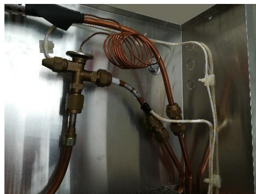
Obr. 5.9: Vstup chladiva do výparníka, upevnenie termočlánkov.
