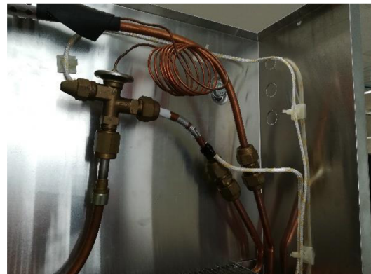
Obr. 5.9: Vstup chladiva do výparníka, upevnenie termočlánkov.
