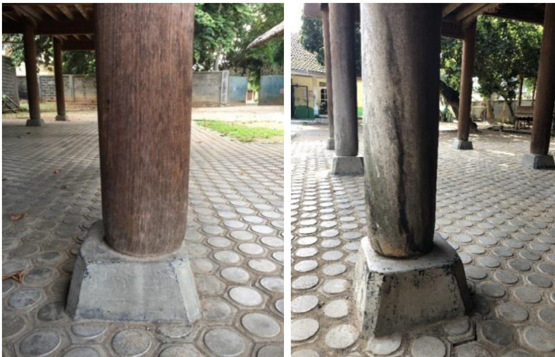
Obrázek 11: Sloupy Rumah Aceh po zemětřesení v roce 2004
