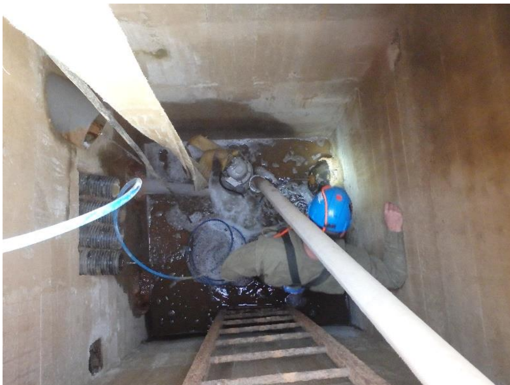
Příloha 14 Čerpání průsakových vod a dočasné uzavírání potrubí vzduchovými vaky z šachtice u odkaliště K1
