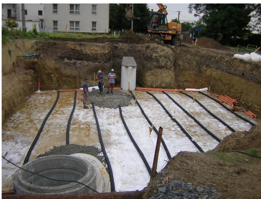
Obrázek 16: Podzemní vsakovací objekt vyplněný štěrkem (Vacek, 2018)
