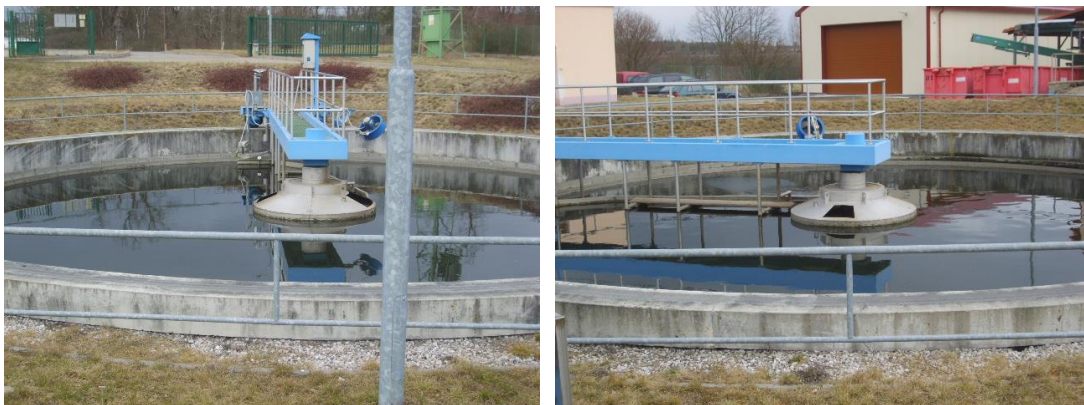
Obr. 16 a 17 - dosazovací nádrže (zdroj vlastní)
