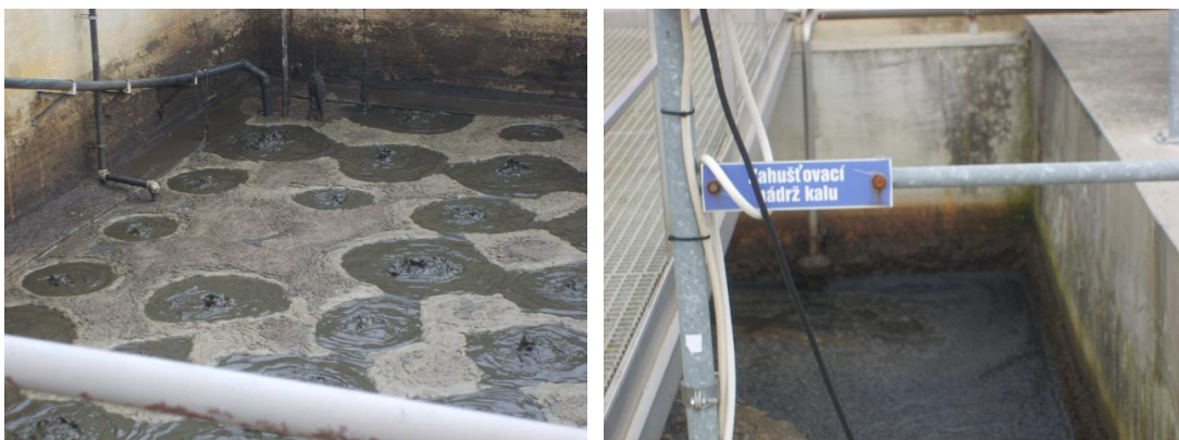
Obr. 19 a 20 – objekt kalového hospodářství – zahušťovací nádrž s aeračními elementy (zdroj vlastní)
