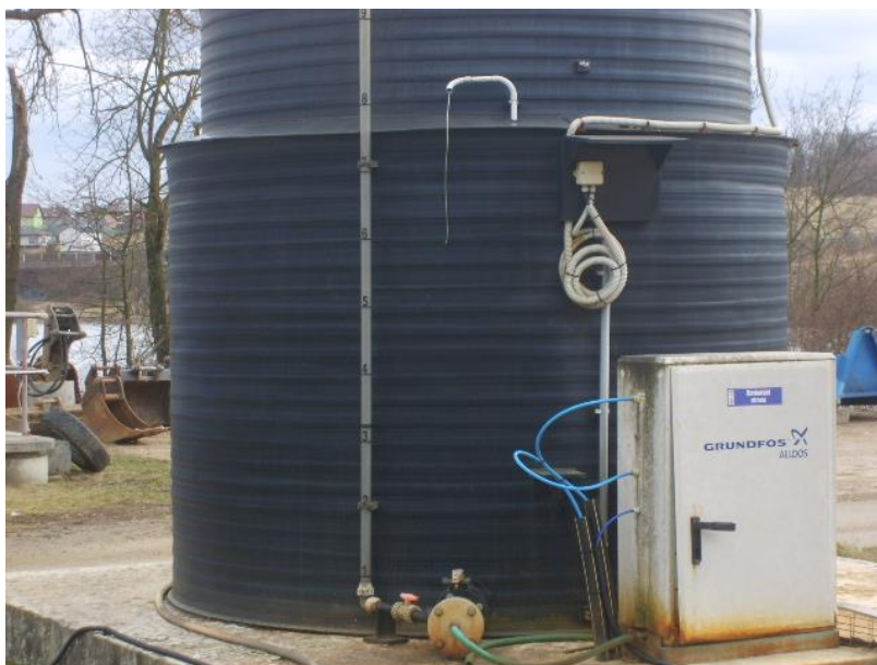
Obr. 18 – dávkovací stanice koagulantu (zdroj vlastní)
