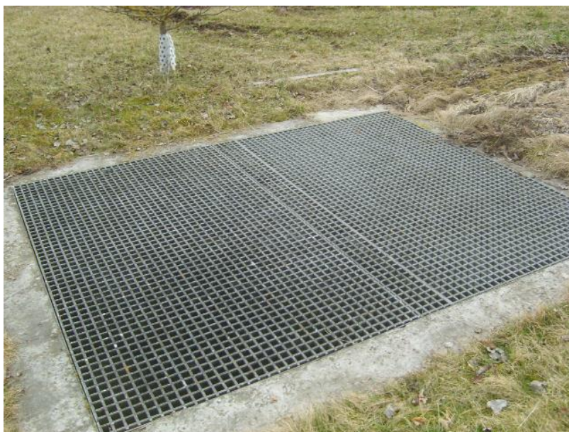
Obr. 5 – odlehčovací komora OK 1 (zdroj vlastní)
