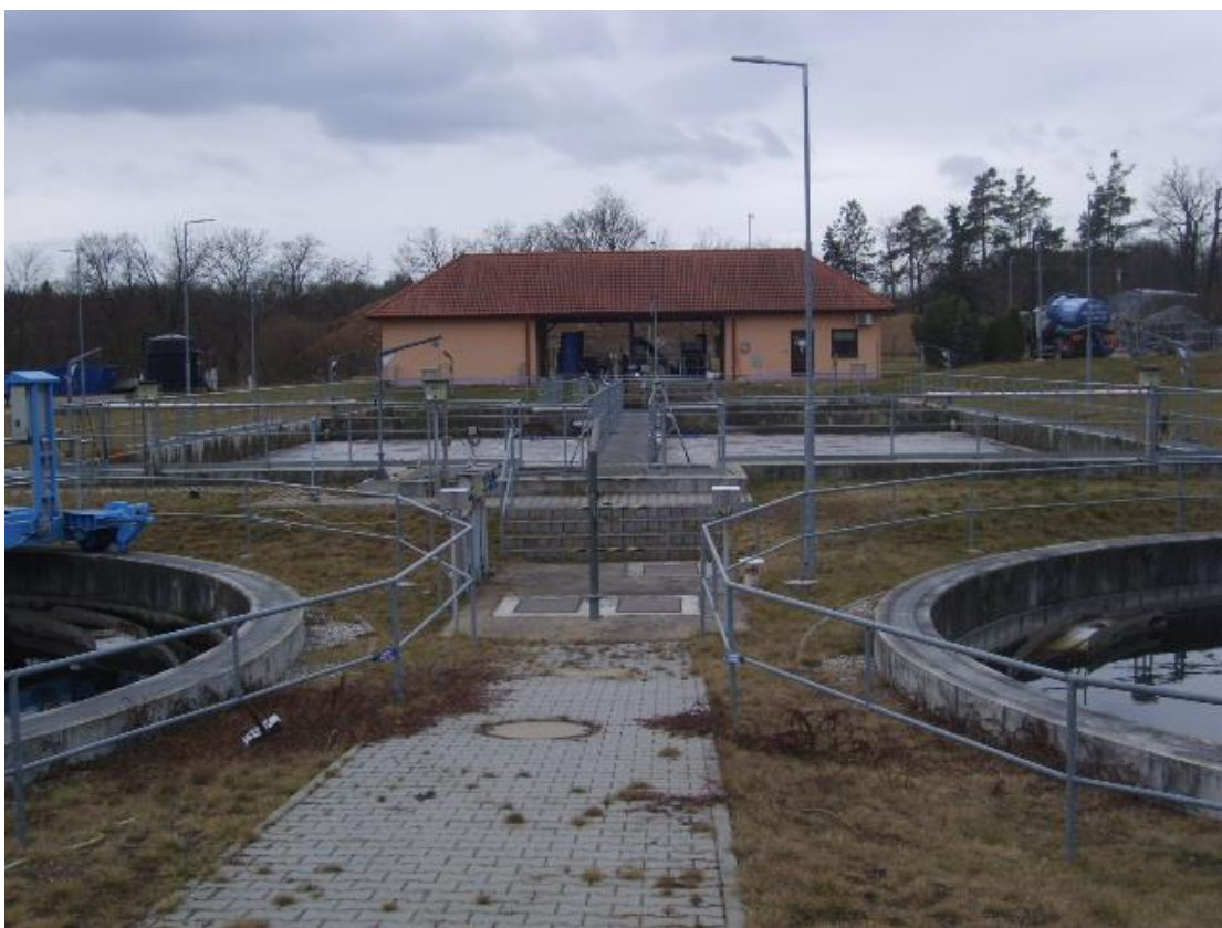
Obr. 21 – celkový pohled na ČOV Dobříš (zdroj vlastní)
