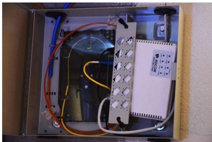
Obr.48- Uložení ONU jednotky. Zde dochází k transformování signálu. Zdroj: archiv Eldata (fotografoval J.Prek)
