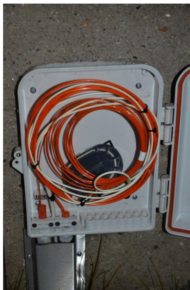
Obr.42- malý rozvaděč v ulici Lidická v Jinočanech. Zdroj: archiv Eldata (fotografoval J.Prek)
