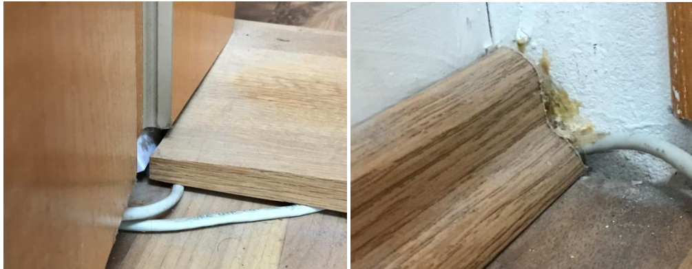
Obr.49- Vedení UTP kabelu pod prahem dveří do rohové lišty Zdroj: archiv Eldata (fotografoval J.Prek)
