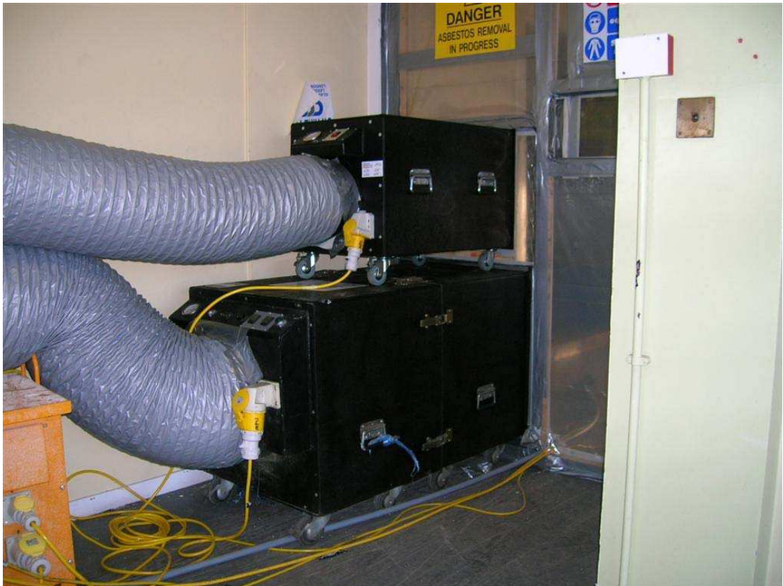
Obr. č. 28: Podtlakové jednotky a potrubí pro odvod vzduchu, průzory a výstražné značení. (EVROPSKÁ KOMISE GŘ, 2006)
