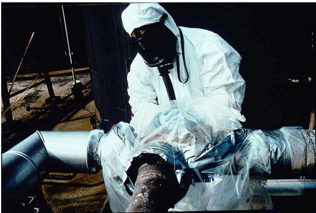
Obr. č. 23: Kontrolované odstraňování azbestového opláštění pomocí vaku s manipulačními rukavicemi (fotografie přetištěny se svolením INRS; copyright INRS). (EVROPSKÁ KOMISE GŘ, 2006)
