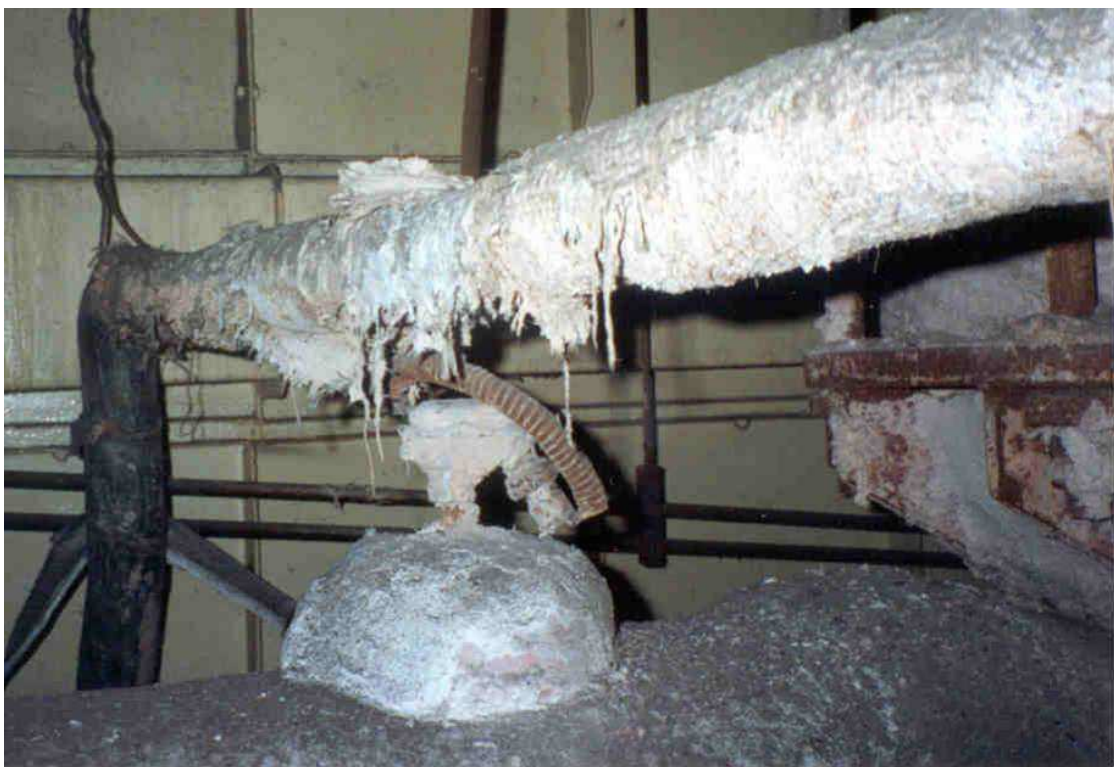
Obr. č. 17: Azbestová izolace na parovodním potrubí. (EVROPSKÁ KOMISE GŘ, 2006)
