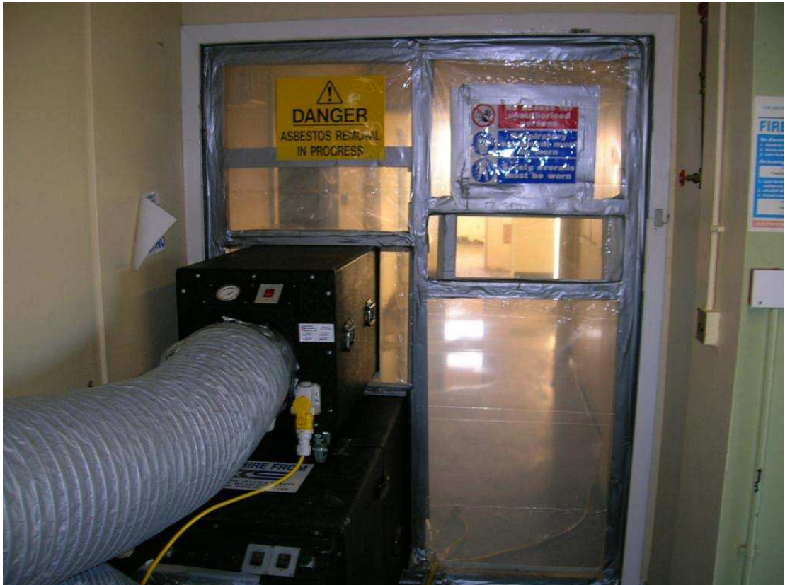
Obr. č. 29: Podtlakové jednotky a potrubí pro odvod vzduchu, průzory a výstražné značení. (EVROPSKÁ KOMISE GŘ, 2006)
