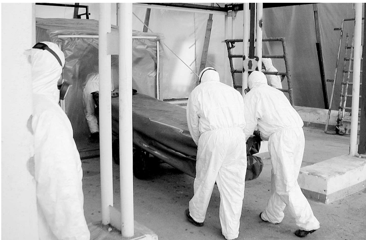
Obr. č. 33: Materiál obsahující azbest odstraňují v kontrolovaném pásmu pracovníci vybavení osobními ochrannými pomůckami. (Lutovská, Krch, 2005)
