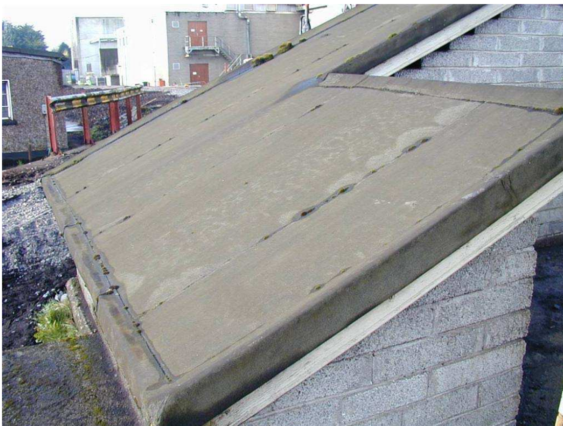
Obr. č. 18: Azbestová krytinová lepenka. (EVROPSKÁ KOMISE GŘ, 2006)
