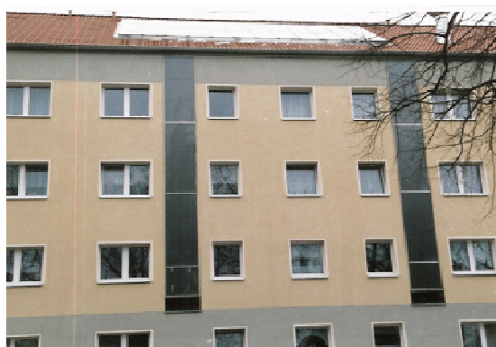
Obr. 5.45 Panelový dům s vertikálně uspořádanými kolektory na fasádě a horizontálně na střeše, Friedland (Německo); [7]
