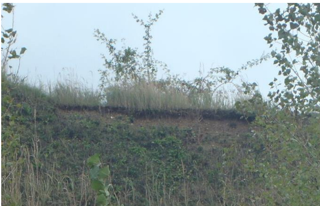
Příloha č. 8 – Břeh podléhající erozi v lokalitě Vojkovice. Zdroj: autorka
