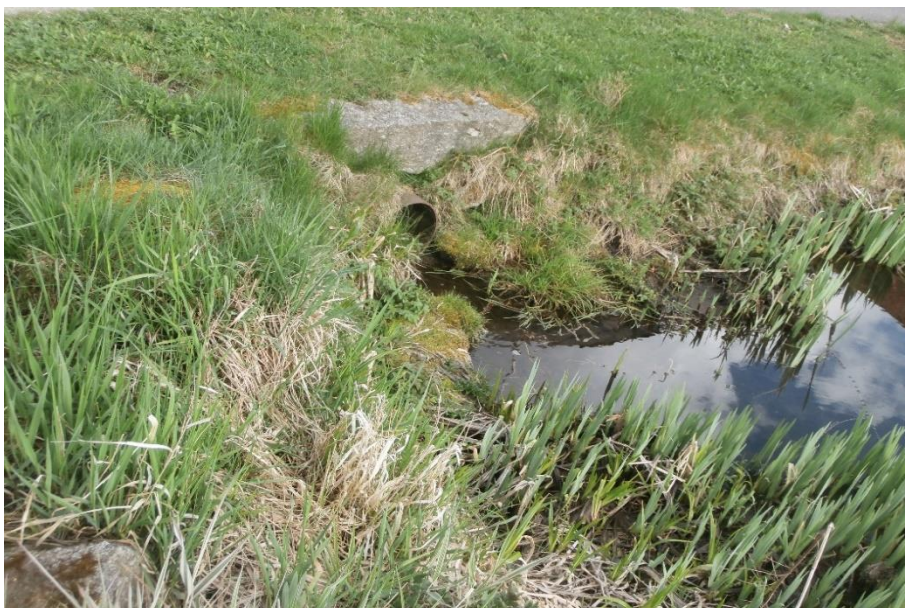
Obr. 27 Přítokové potrubí MVN Návesní rybník
