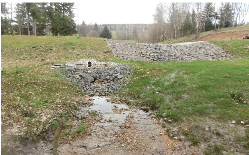
Obr. 44 Vyústění potrubí + přelivová hrana MVN Panský rybník III.
