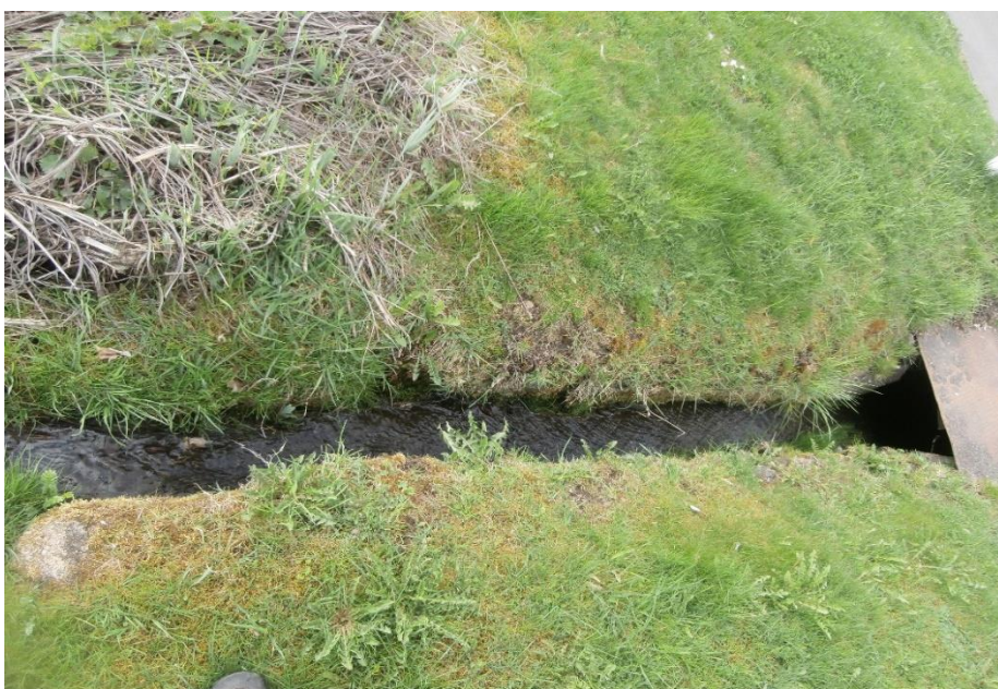
Obr. 28 Výpustné potrubí MVN Návesní rybník
