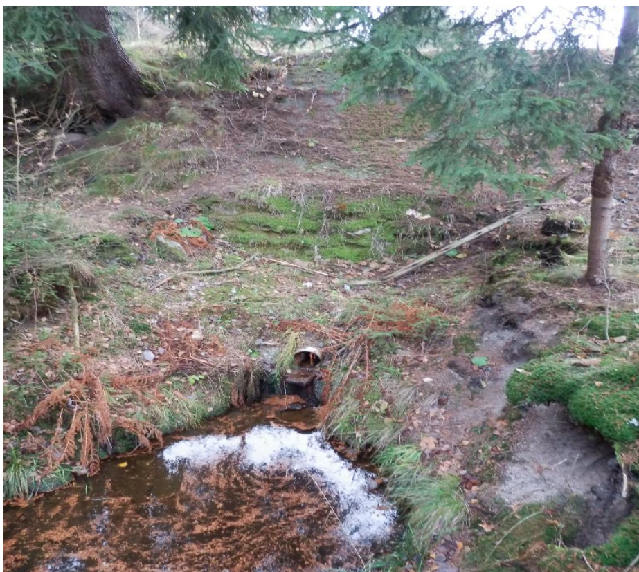
Obr. 25 Vyústění vypouštěcího potrubí MVN Josef
