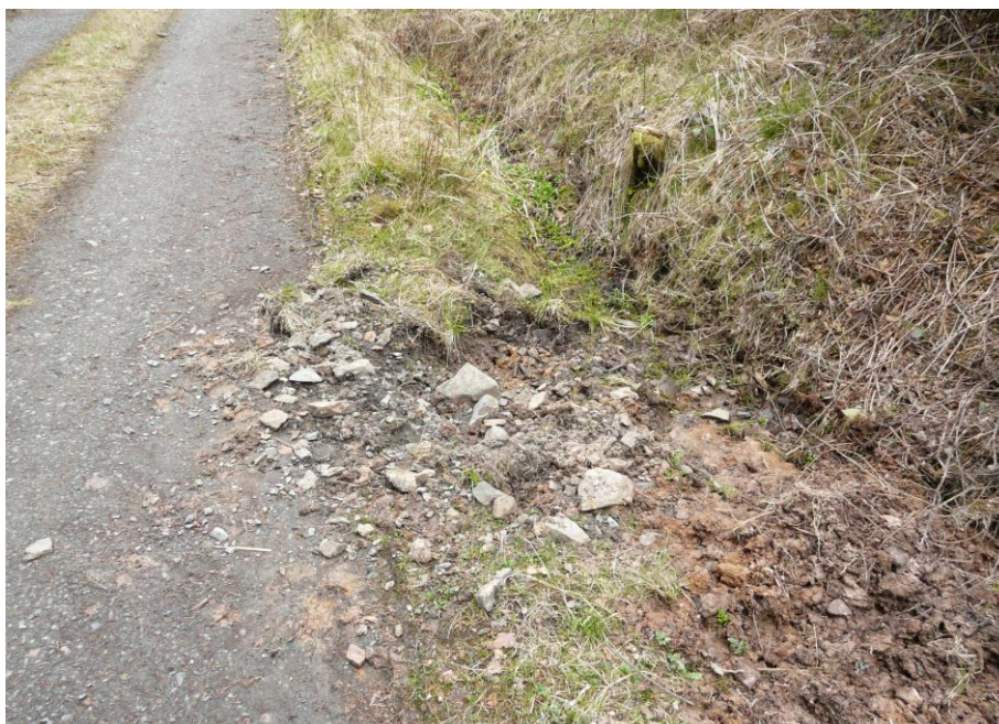
Příloha č. 7 – Poškození okraje lesní cesty (foto: Bach)
