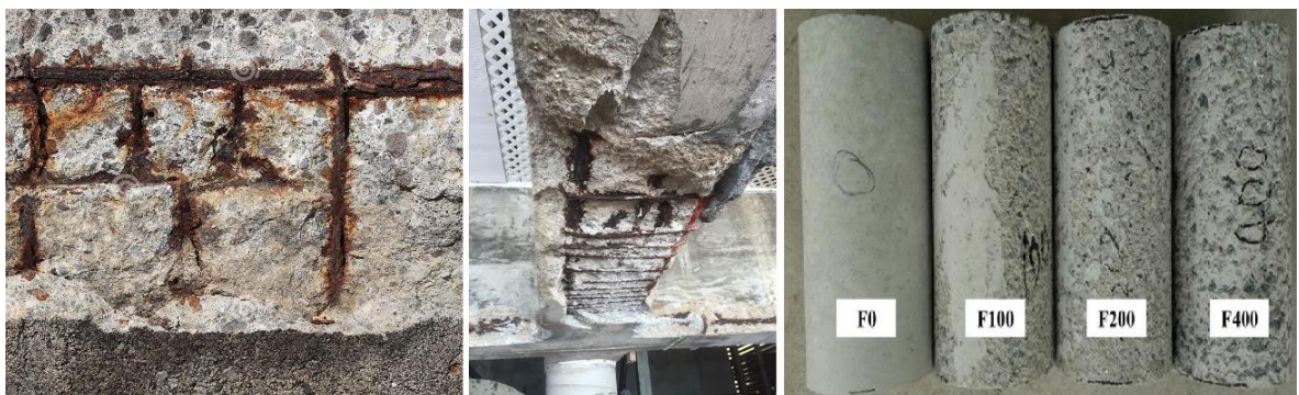
Obr. 11: Odlupování povrchových vrstev betonu [37] [38] [39].
